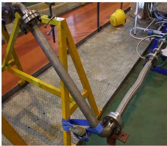
Figure 5 TUV NEL 1 st water installation - Inlet
